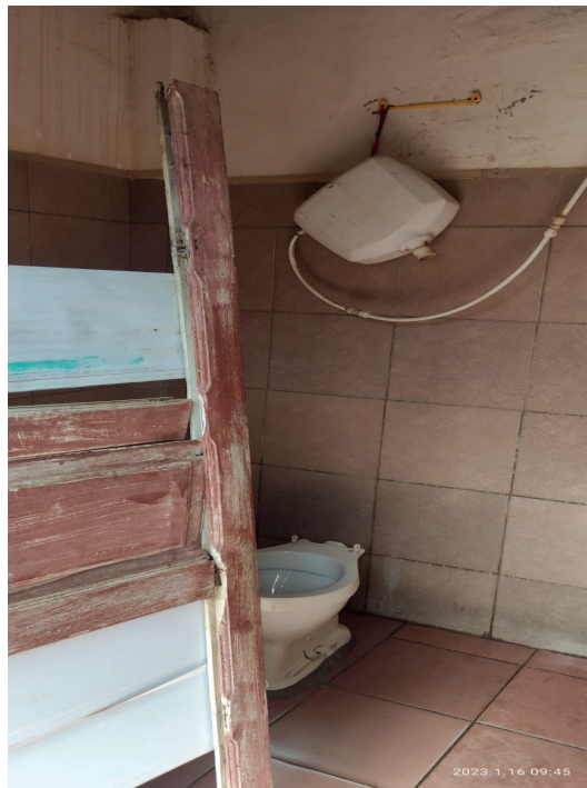
Baños en mal estado en el centro penitenciario de Mocovi, Trinidad.
