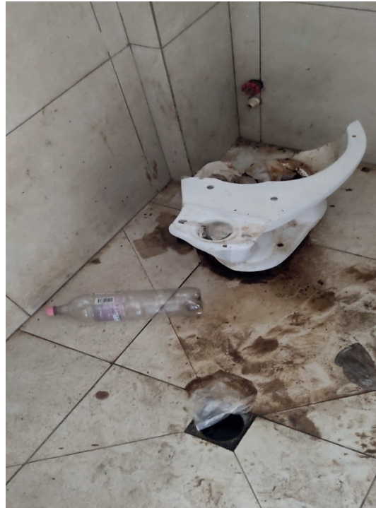
Baño destrozado en el centro penitenciario de Mocovi, Trinidad.
