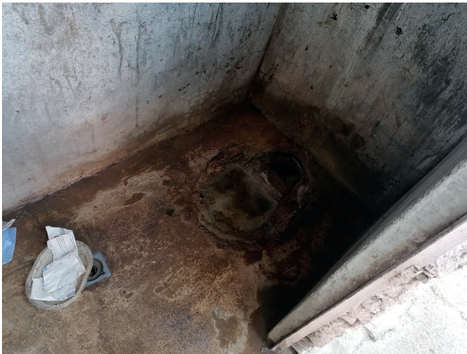
Sanitarios en mal estado, en el Sector E-2 de Chonchocoro, no cuentan con ducha ni baño.
